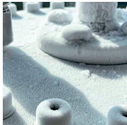
Рис. 9. Образование снежной «шубы» на корпусе погружной криогенной центробежной насосной установки MV&F для заправки сжиженного природного газа в автомобильные топливные баки
