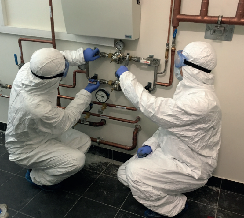
Рис.2. Установка газового щита MV&F с регуляторами давления RegO в ковидном госпитале в Коммунарке, апрель 2020 г.
